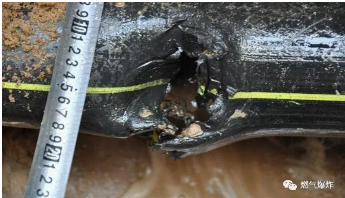
图 4 燃气管道泄漏点
